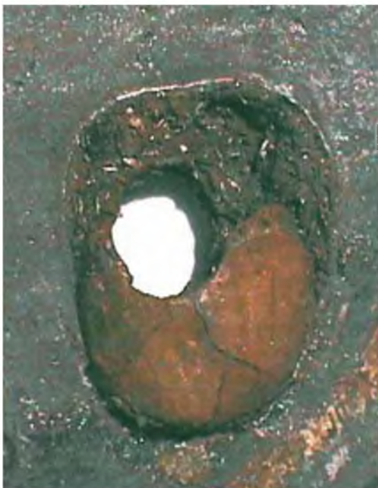
Zdj. 1: szczegółowy widok zniszczonego kanału wody w uszczelce podgłowicowej z materiału miękkiego
